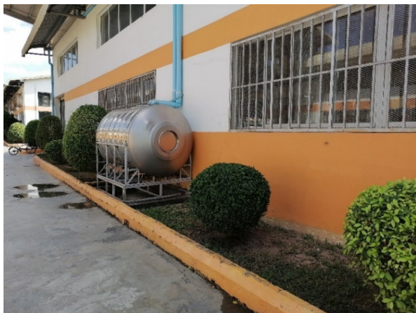
【廁所沖洗水使用再生水】
